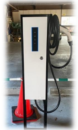
EV充電設備
