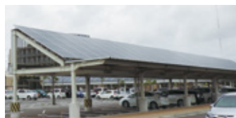
敷地内にある太陽光発電システム。 発電された電力は、すべて院内で活用されている
