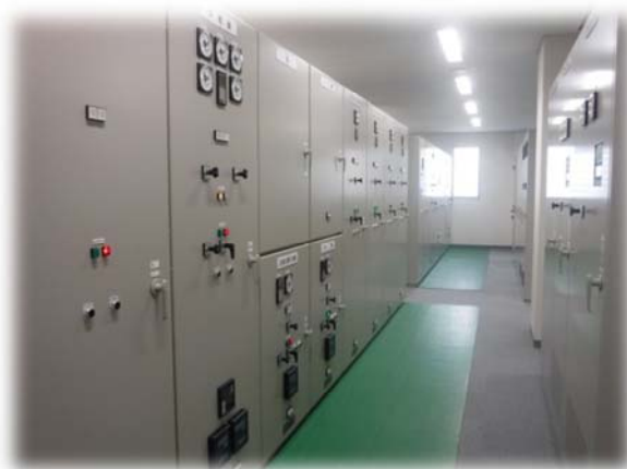
受変電設備（三口浄水場）
