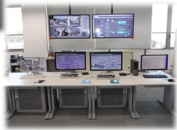
中央監視設備（三口浄水場）
