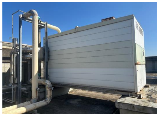
【吸収式冷温水機】
