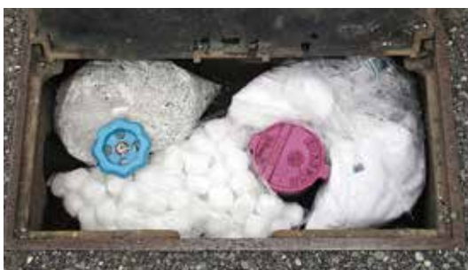
メーターボックスの保温状況
