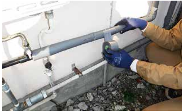
給湯器周りの保温対策の状況
