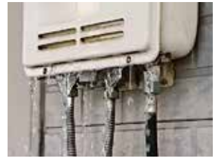
水抜きを忘れて破裂した給湯器
