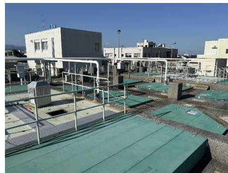
②-1 最初沈殿池
