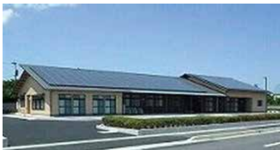
[ 大幡コミュニティセンターの太陽光パネル ]
