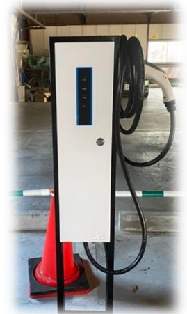
EV充電設備
